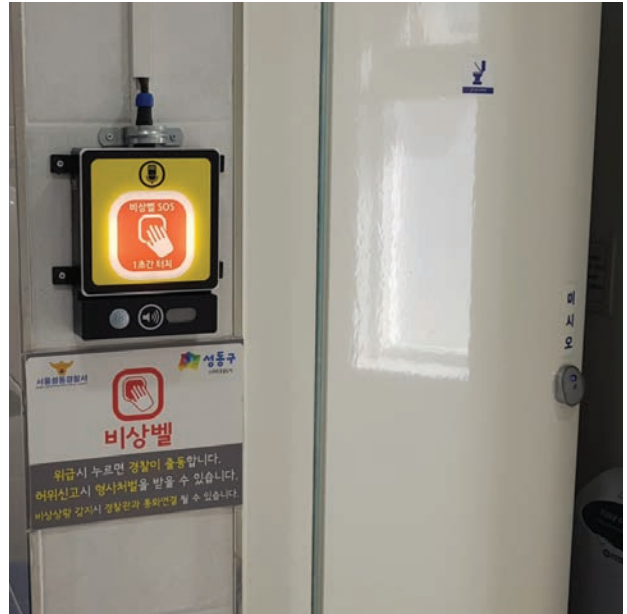
화장실 내부에 비상벨 설치 [서울시 성동구 공중화장실]
