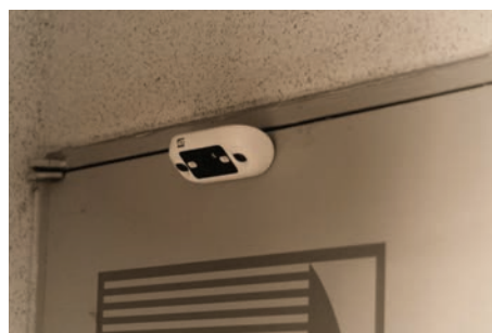
단위세대 현관문에 감시시설 설치
