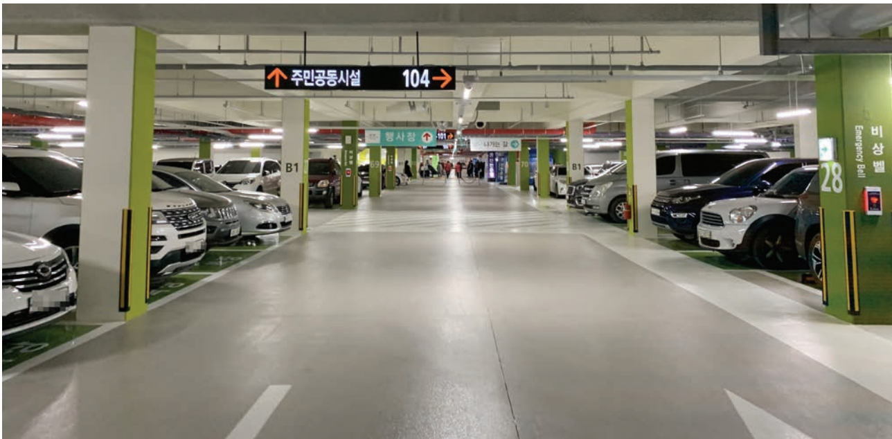
주차장에 일정 간격 비상벨 설치와 바닥, 벽면, 천장, 위치 안내를 위한 표지판 또는 사인 그래픽을 설치하고 밝은 색채의 마감재료를 사용 [인천시 송도 호반베르디움 3차]
