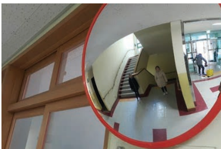
복도 및 계단실에 사각지대가 형성되지 않도록 계획하며 안전거울 및 CCTV 설치 [울산시]
