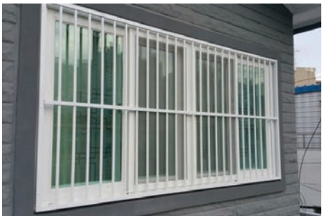
저층 주거지나 측벽에 위치한 창문에는 강한 충격에도 파손되지 않는 방범창 설치
