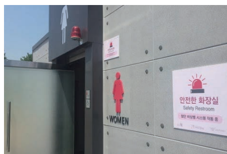
여자 화장실 중심으로 내부에 비상벨 설치와 외부에는 비상벨과 연계된 경광등 설치
